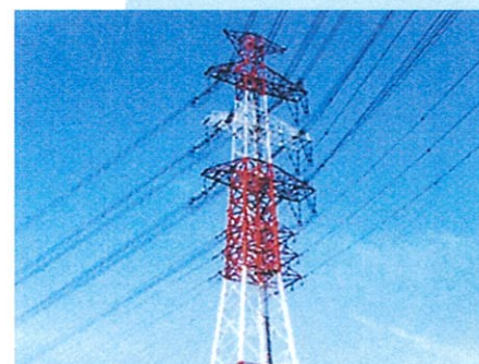
中部電力(株) 鉄塔
