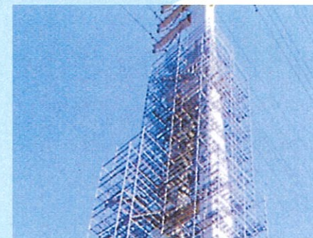
関西電力(株) 鉄塔
